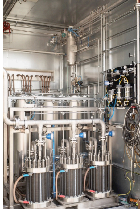
The PEM electrolyser
